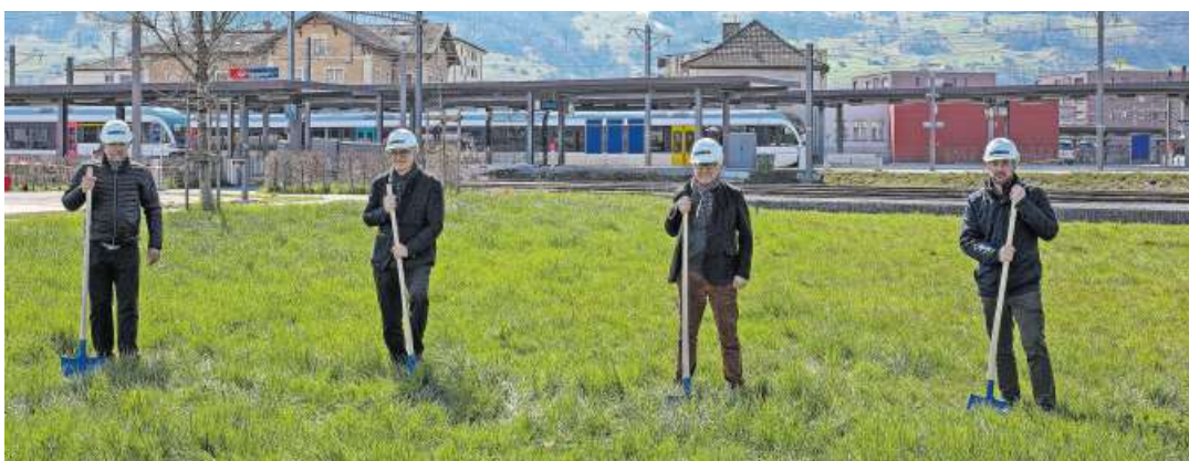
Gemeinsam ans Werk: Christoph Eicher, CEO Psychiatriedienste Süd, Urs Spirig, Architekt bei der Spirig Partner AG, Peter von Rotz, Bauherr von der Electracom AG, und der Sarganser Gemeindepräsident Jörg Tanner nehmen den Spatenstich vor.
